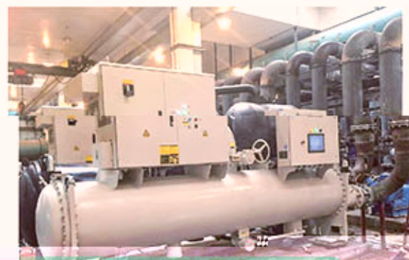
中车株洲所中央空调变频器在人民大会堂服役
